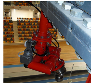
Elektrisch bedienten Löschmonitor
